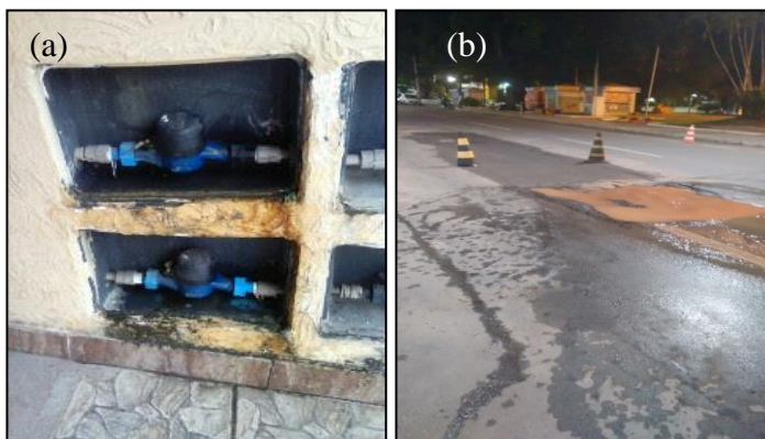
Figura 3: Vazamento de caixa e ramal, respectivamente, na cidade de Alagoínhas.
