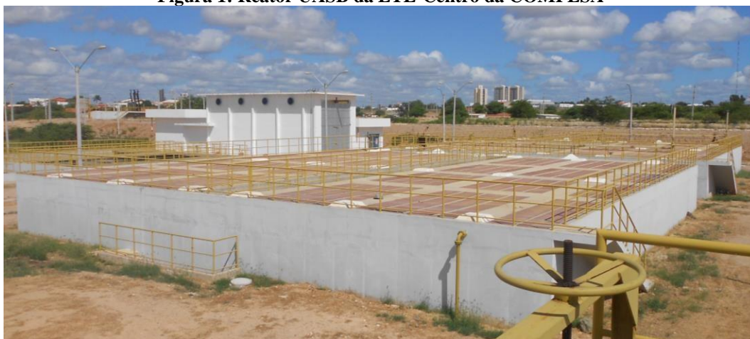
Figura 1: Reator UASB da ETE-Centro da COMPESA
